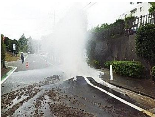
老朽化した配水管からの漏水 (横浜市水道局HPより)
