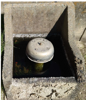
一筆分水栓（給水栓）
