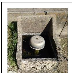
一筆分水栓（給水栓）
