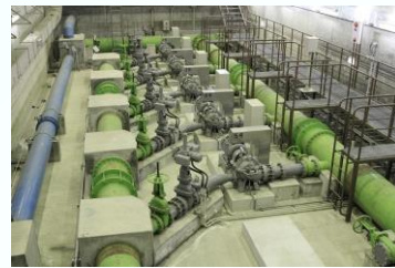
下般若配水場ポンプ室内
