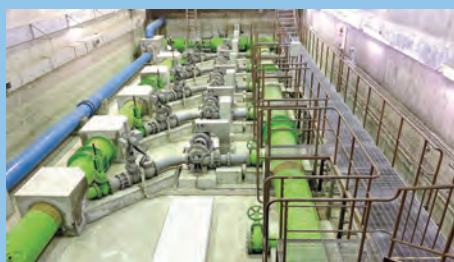
下般若配水場配水ポンプ設備
