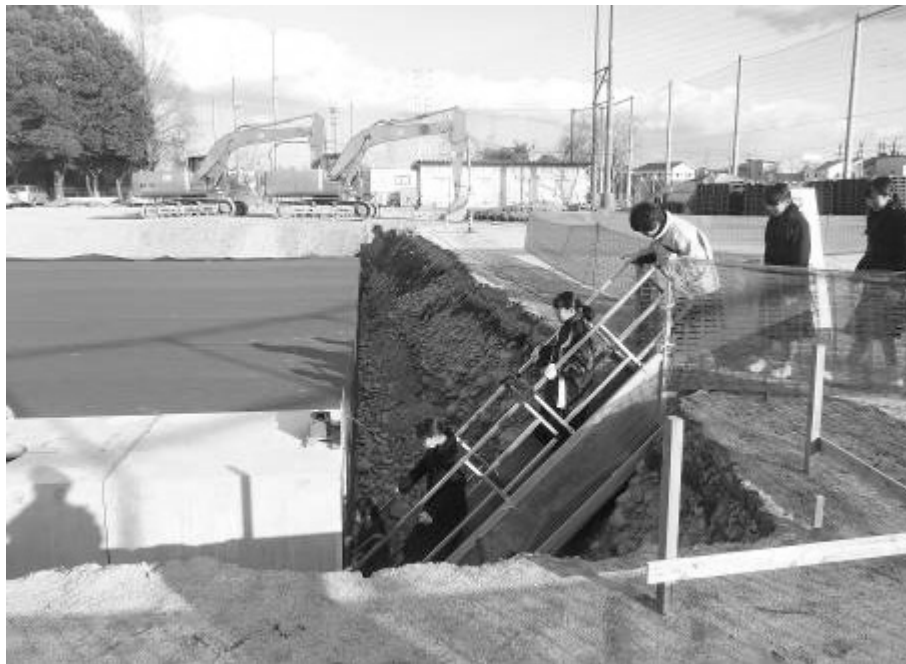
雨水貯留浸透施設の見学（北部中学校）
