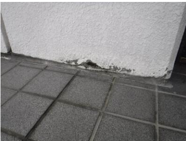
古知野西公民館（部分的な剥離、ひび割れ等）
