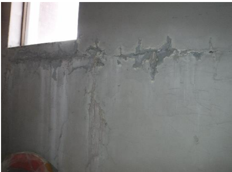
写真 建築物内部への漏水・遊離石灰
