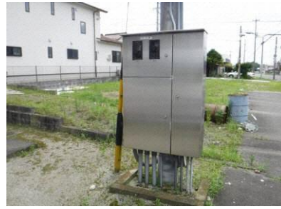
学習等供用施設草井会館 (H6 建設 24年経過 受電設備更新済) (不具合等の報告は特になし)
