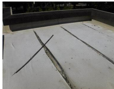
中央公園（便所兼機械室）（全体的なはがれ、天井漏水あり）
