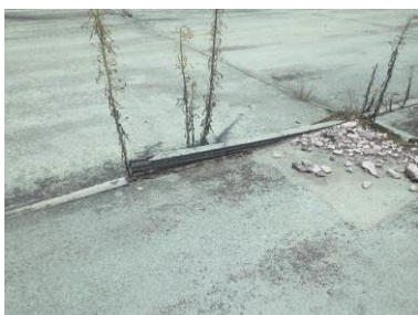
旧養護老人ホームむつみ（局所的な劣化、天井漏水なし）
