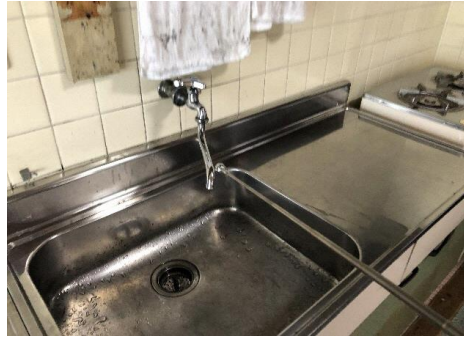
写真 衛生設備の老朽化（赤水発生）
