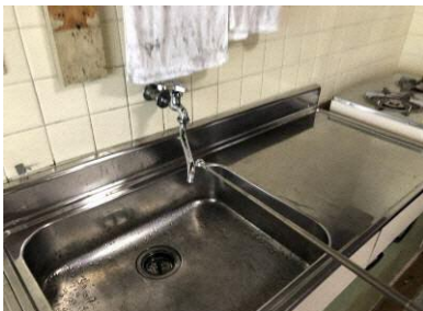
古知野北公民館 (赤水の発生、シンク排水不良 等) 改修履歴「H16 防災設備、H25 空調」 経過年数 58 年で給排水管の全面改修に関する工事 履歴なし
