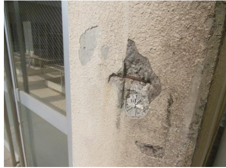
写真 外壁の剥離・鉄筋露出
