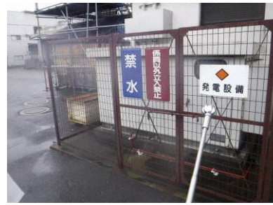
消防本部 (本署) (自家発電設備 30年経過 昨年度一時停止) 改修履歴「H27 通信室、H29 変電設備」
