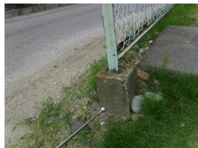
草井地区学習等供用施設 (S51 建設) (フェンス腐食、破損、ぐらつき、基礎転倒の恐れ 改修履歴なし)
