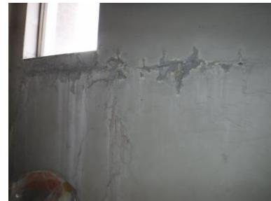
老人福祉センター (ひび割れ多数、一部から漏水遊離石灰あり)
