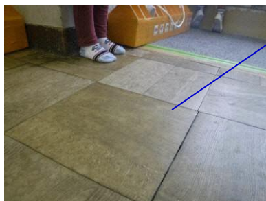
藤里保育園 (隙間から虫の侵入 その他内装の劣化多数)
