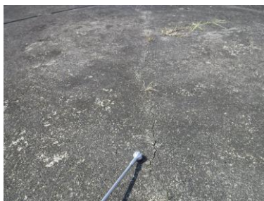
布袋北部地区学習等供用施設（押さえコンのひび割れ）
