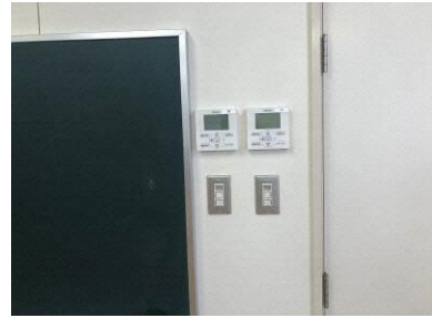
学習等供用施設小脇会館 (空調更新済)
