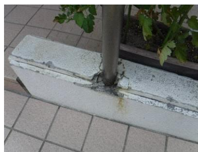
古知野児童館 (H11 建設 手摺支柱基部のCo剥離) (その他劣化なし、屋外の改修履歴なし)
