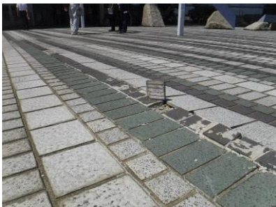
市民文化会館 (S59 建設) (タイルの浮き、剥離、段差等が多数、 つまづきの恐れあり) 改修履歴「H25 駐車場」
