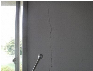
古知野東公民館 (壁のひび割れ等)
