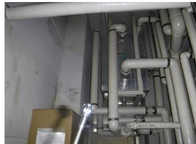
消防本部 (本署) (膨張タンクの水漏れ、停止) 改修履歴「H16 ポンプ類、H23 空調、H24 ガス管」 経過年数 32 年
