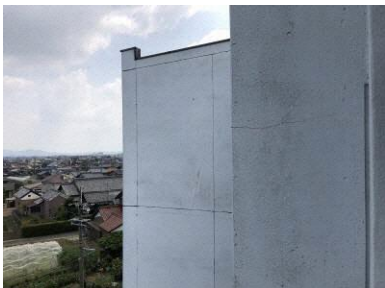
古知野東小学校-校舎（広範囲にひび割れ、錆汁の疑い、漏水あり）
