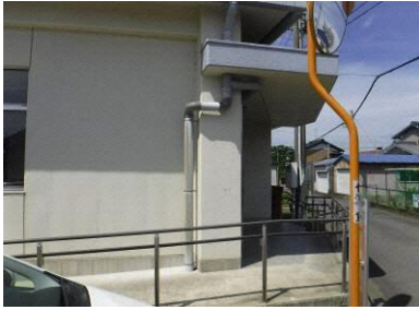
学習等供用施設江森会館（塗替済 工事履歴不明）
