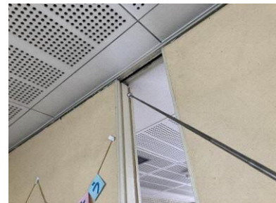
草井保育園 (建具の動作不良、建付不具合等)
