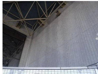
市民文化会館（広範囲のタイル浮き、剥がれ 漏水あり）
