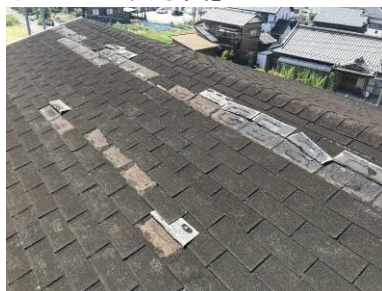
宮田地区学習等供用施設（広範囲の屋根材の劣化、落下多数）
