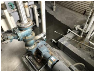
わかくさ園 (空調機器の腐食、水漏れ、滞水) 改修履歴「H21 給水管」 経過年数 44 年
