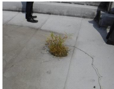
老人福祉センター（シート破れ多数-天井漏水あり）
