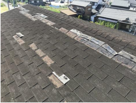
写真 屋根材の劣化
