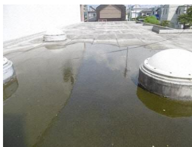
古知野南小学校-体育館（排水不良-天井漏水あり）
