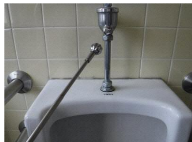
布袋北部地区学習等供用施設 (水洗不良 水が止まらない時がある) 改修履歴「H13 空調、H14 下水接続、H15 便所、 H24 ガス管」
