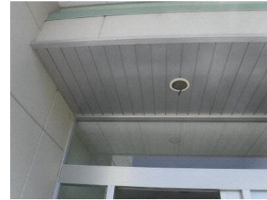
環境事業センター (H13 建設 17年経過) (ライトコーキング劣化)
