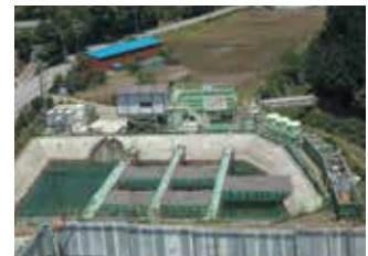
濁水処理設備と竹ソダ式沈砂池
