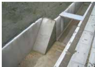
小動物が側溝に落ちてでも這い上げられるように設置された斜路(スロープ)
