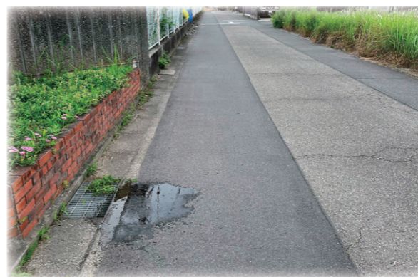
舗装の切れ目などから水が染み出ることがあります(画像はイメージ)
