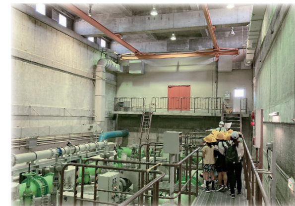
配水場内ポンプ室での見学の様子
