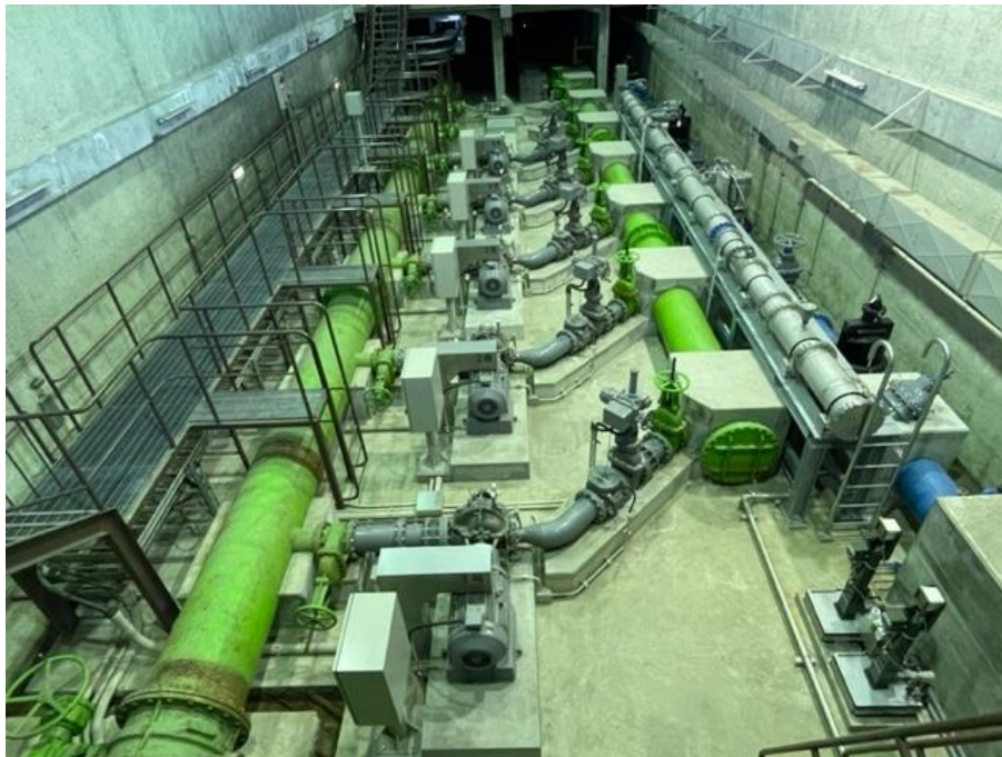
下般若配水場ポンプ室
